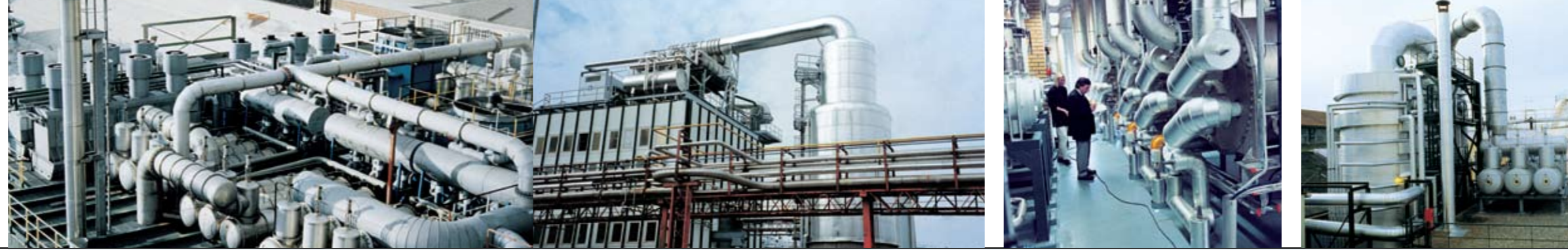
置于屋顶上的4台干式冷凝器, Walter Rau, 诺伊斯, 德国
